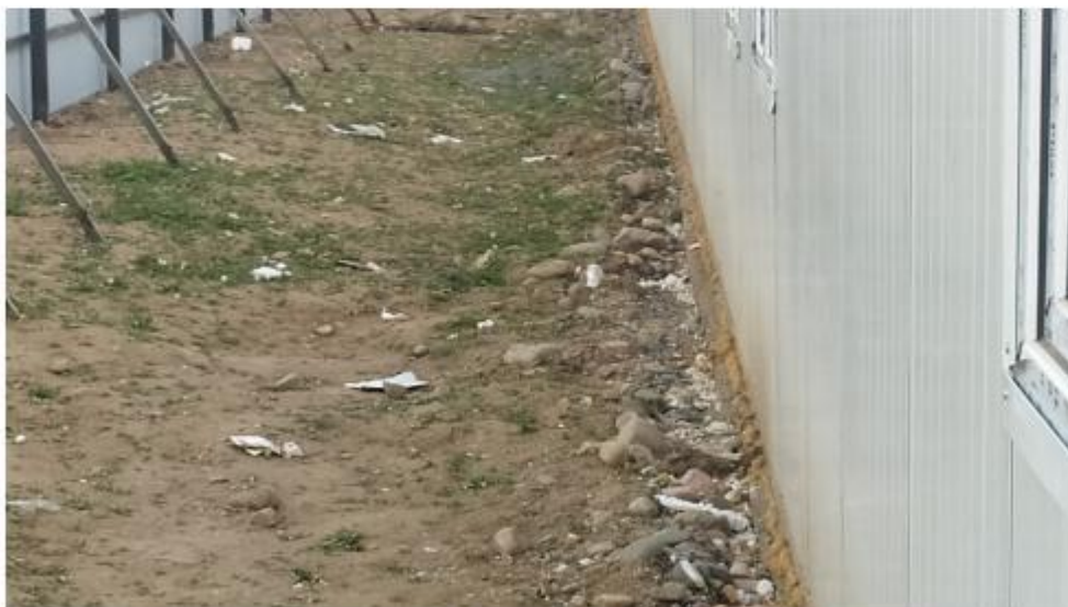
Фото 4: не соблюдается чистота на участке
